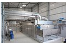
HUBER Bandrocknungsanlage Nova Gorica, Slowenien
